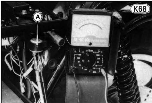
A. Hazard Relay
